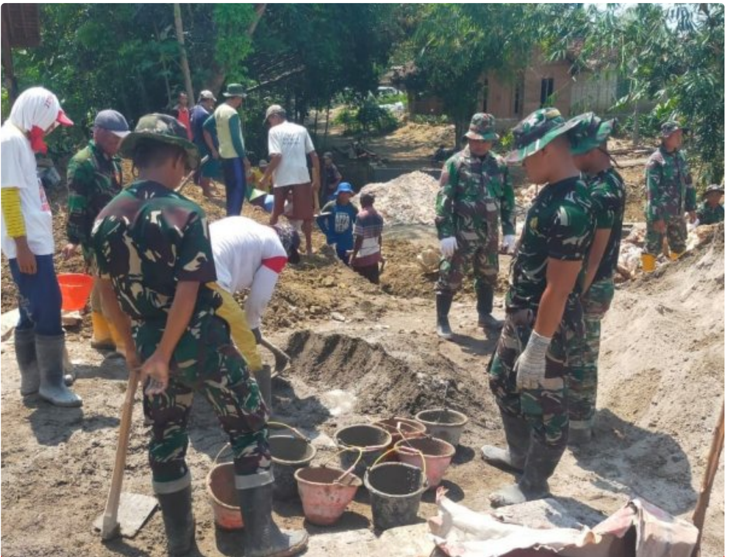
Foto: Satgas TMMD Reguler ke-122 Tahun 2024 Kodim 0721/Blora melaksanakan gotong royong pengecoran talud jembatan bersama masyarakat Desa Sidomulyo, Kecamatan Banjarejo, Kabupaten Blora, Jawa Tengah, Minggu (06/10/2024).
